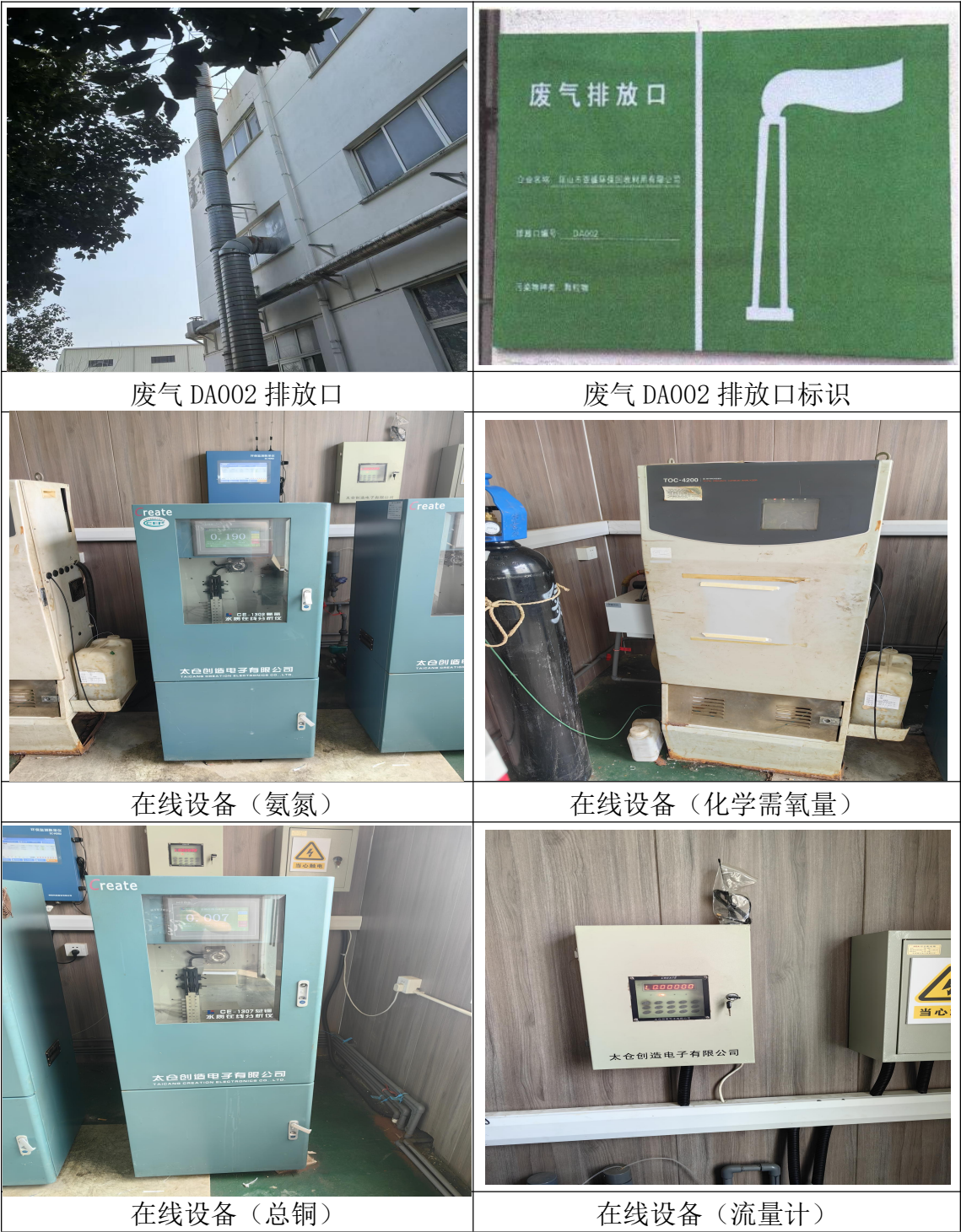
图 4.2.2-1 规范化排污口及在线监测装置现场图
